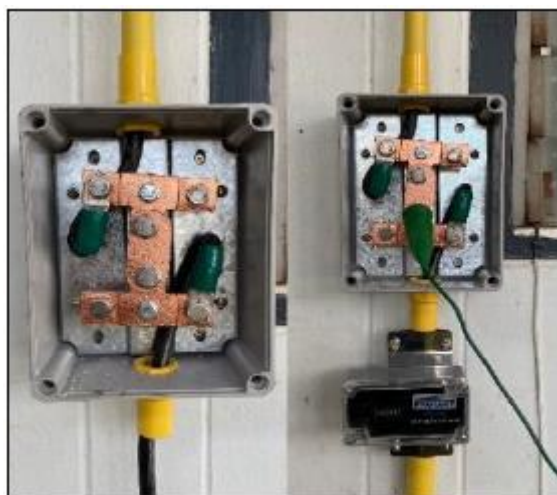
ภาพ 10 กล่องทดสอบภาคพื้นดิน (Ground Test Box) และอุปกรณ์นับจำนวนครั้งฟ้าผ่า (Lightning Strike Counter)
