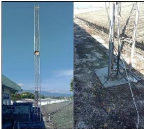
ภาพ 2 ตัวนำล่อฟ้าถูกติดตั้งบนยอดของเสาวิทยุคมนาคม
