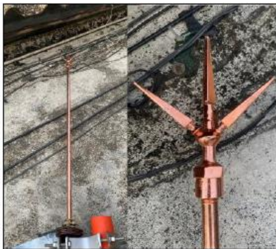
ภาพ 5 แท่งตัวนำล่อฟ้าแฟรงกลิน ความยาว 1 เมตร ติดตั้งอยู่บนยอดของเสาวิทยุคมนาคม
