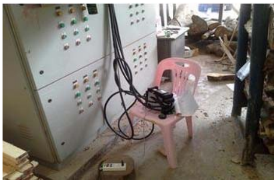
รูปที่ 2 การติดตั้งอุปกรณ์ควบคุมภาระของมอเตอร์กับเครื่องเลื่อยไม้ซุงยางพารา
