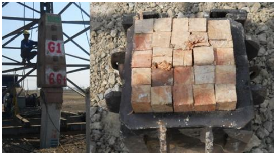
ภาพที่ 4 ตัวอย่างการใช้ไม้หลายชิ้นเป็นกรณีหนึ่งที่มีผลทำให้เสาเข็มล้มตึง
