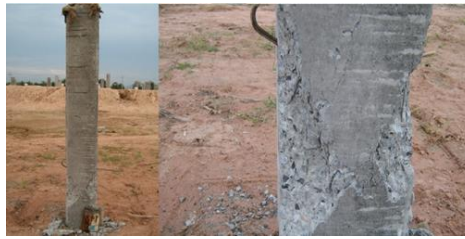
ภาพที่ 7 เสาค้ำเสียหายจากสาเหตุ Over Compressive Stress
