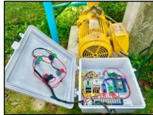
ภาพ 2 อุปกรณ์เปิด-ปิดระบบสูบน้ำอัตโนมัติ
